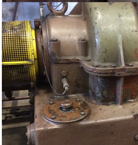
Obr. 1 Takto to být nemá. Veškeré poletující částice a vlhkost se dostávají do oleje. Nešťastné je řešení, kdy vnější prostředí kontaminuje olejová mlha.
