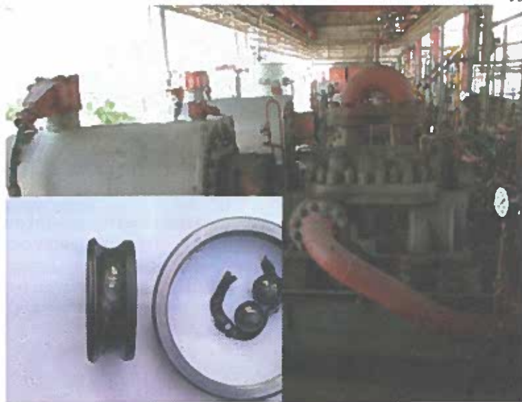
Poškodenie ložiska od termálnej dilatácie potrubia
