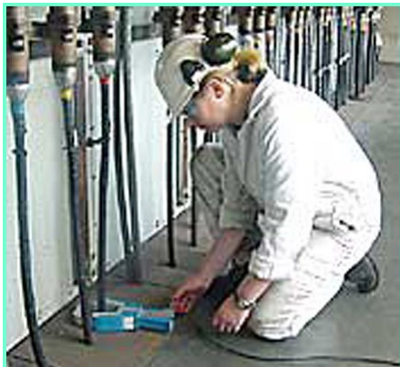
Obr. 1 Snímanie prúdu kliešťovým ampérmetrom v rozvodni.
